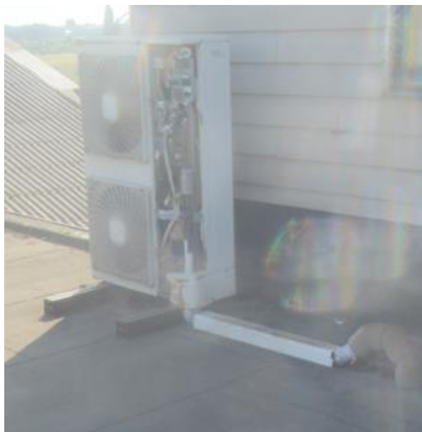
Figure 3 : PAC en toiture.
